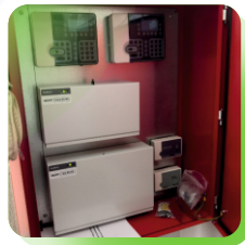
Пожарная и охранная сигнализация
